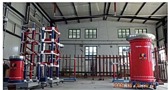
箱式变电站试验室
